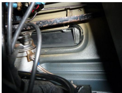
Luftklappe von unten gesehen
